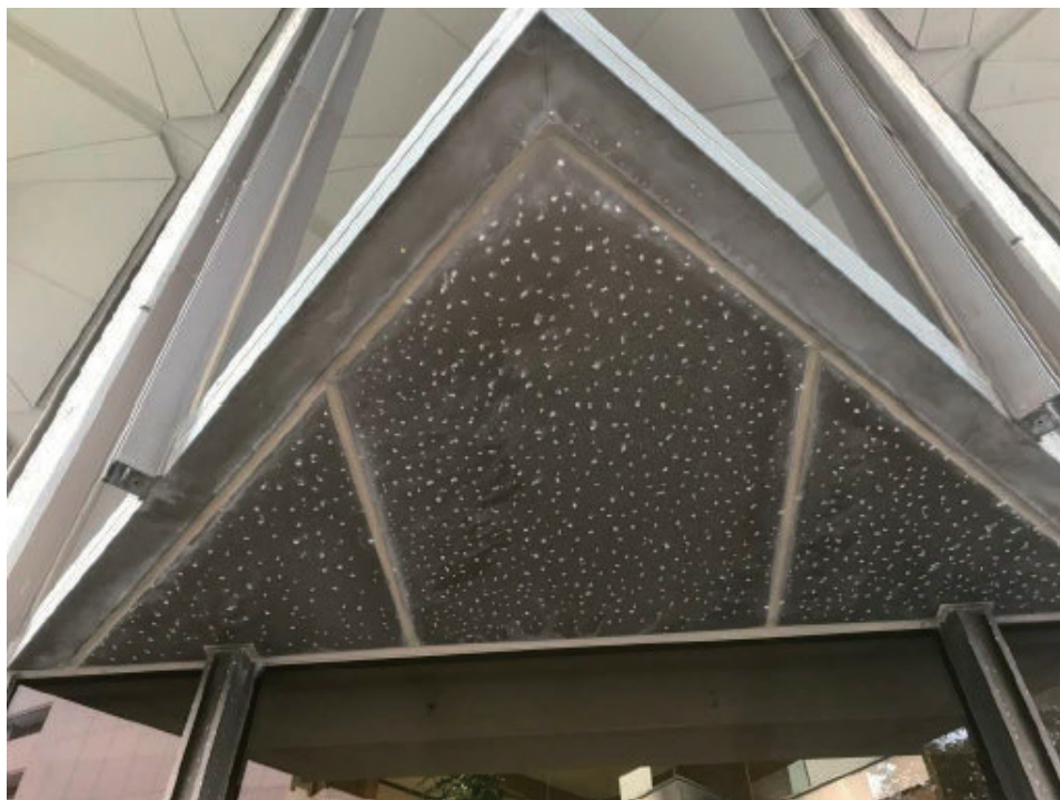
アルミ鋼板に白サビが発生して傷んでいる
