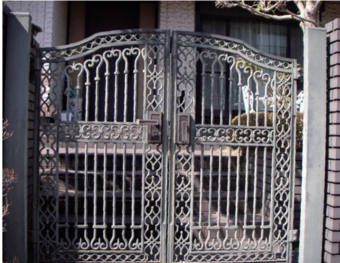
チョーキングが発生している
