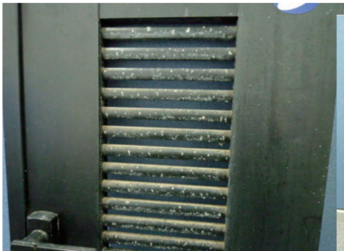
白サビが発生して、アルミが腐食
