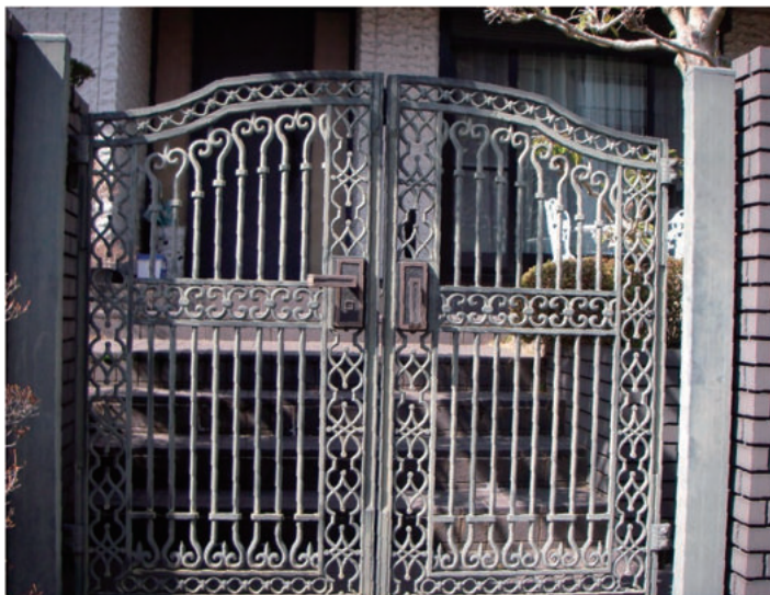
チョーキングが発生している
